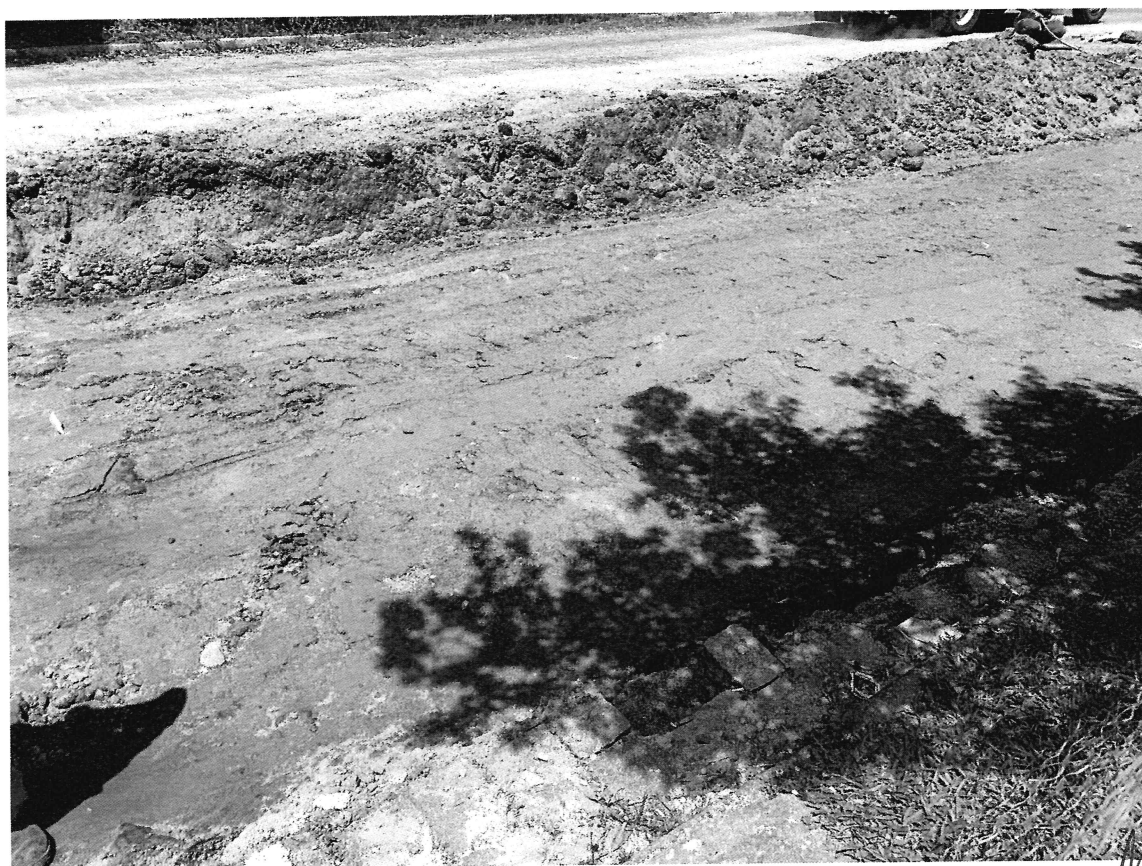
Figura 4 - Presença de deformações excessivas - "borrachudo"
